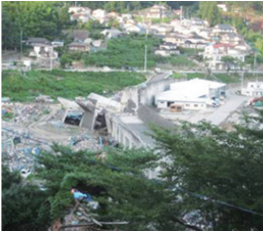
破壊された防波堤
